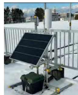
図 9 太陽光パネルによる基地局の設置。
