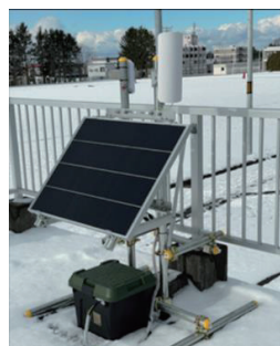
図 9 太陽光パネルによる基地局の設置。
