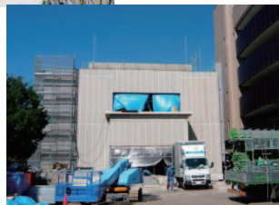
写真上:整備中の青葉山新キャンパス(手前はセンター新棟) 写真下:センター新棟工事
