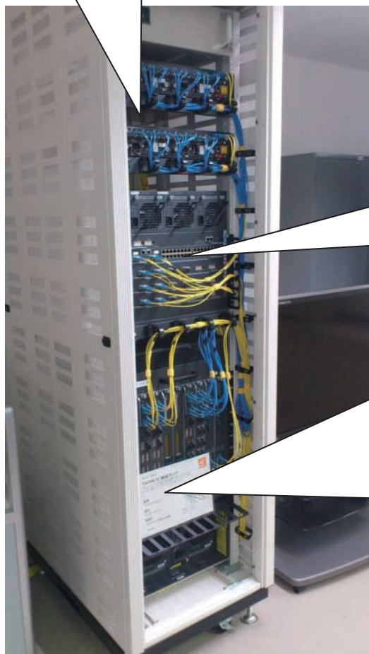
写真 1 2 19 インチラック
