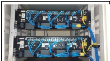
写真 1 3 波長多重化装置 (NEC 社製 Metro Giga 8000)
