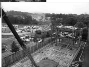
写真上:整備中の青葉山新キャンパス 写真下:センター新棟工事
