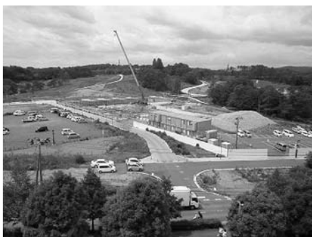
サイバーサイエンスセンター前 整備中の青葉山新キャンパス
